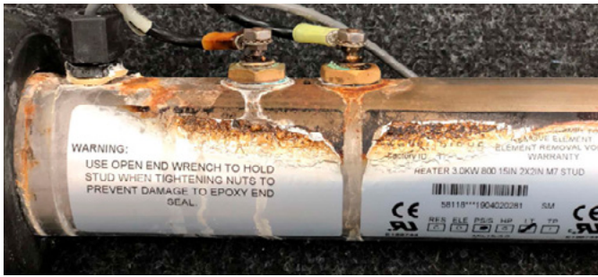
Eroderet varmelegeme med tærede pakninger.
